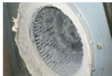
←約27年使用後の2階トイレ排気ファンの内部の様子
