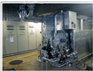
(吸収冷温水発生機)
